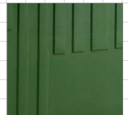
paroi antérieure cuve renforcée
